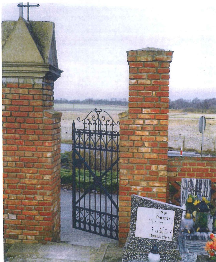
Fot.19. Brama wejściowa flankowana słupkami. Widoczny brak cementowej nakrywy.
