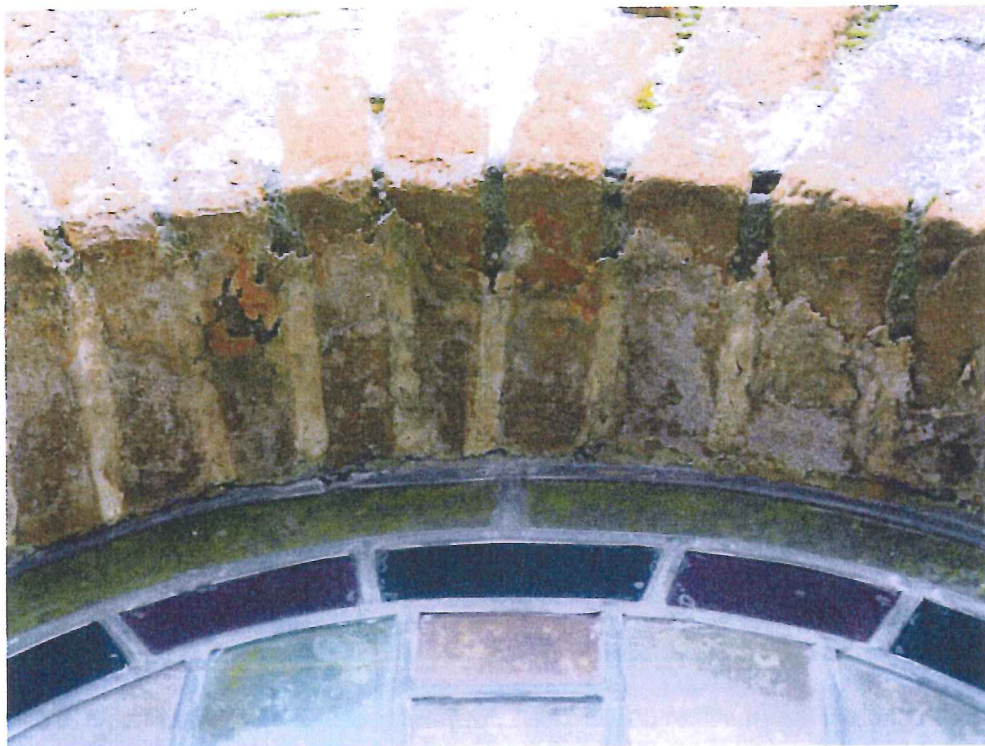
Fot.8. Przemalowanie ościeża okiennego po północno-zachodniej stronie kaplicy.
