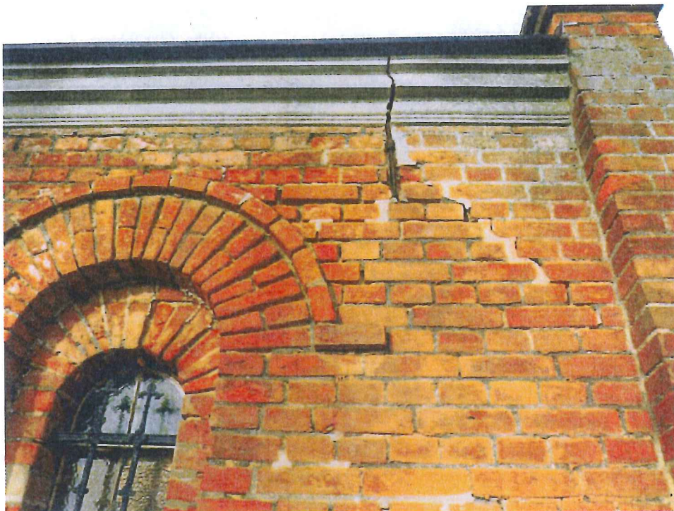
Fot.4. Fragment muru kaplicy grobowej od strony południowo-wschodniej. Widoczne pęknięcie muru i znaczne ubytki spoin.
