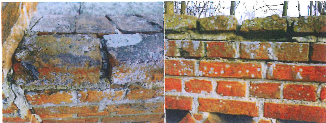
Fot.18. Przykład zniszczeń ceglanej nakrywy i ubytków spoin na przesłach ogrodzenia.
