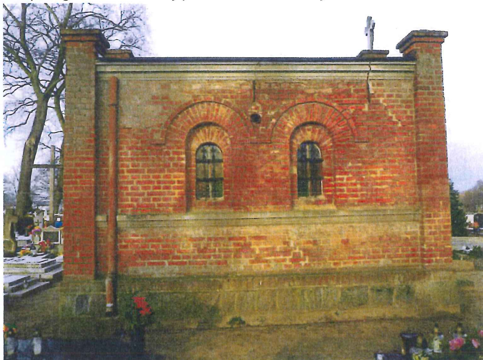
Fot.3. Kaplica grobowa od strony południowo-wschodniej. Widoczne zniszczenia i spękania partii muru.
