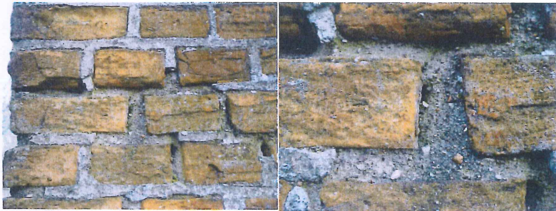
Fot.16. Fragment lica ceglanego na słupach w bramie wejściowej. Widoczne ubytki cegieł oraz stan zachowania oryginalnych spoin pod wtórną zaprawą cementową.
