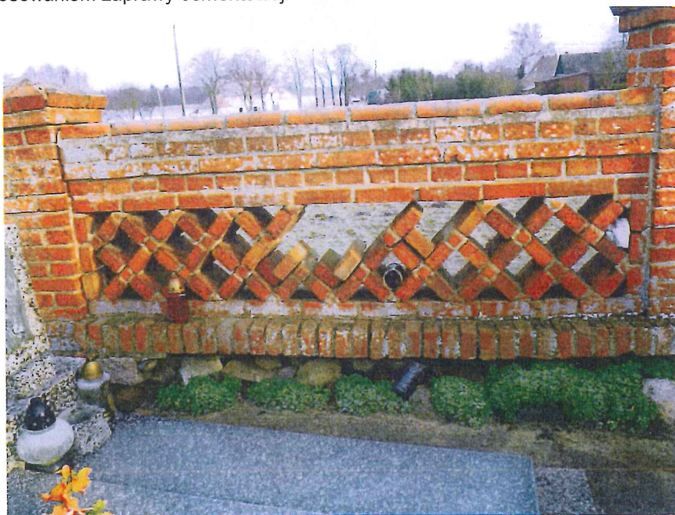
Fot.14. Przykład stanu zachowania jednego z przęseł ogrodzenia. Widoczne zniszczenia: ubytki spoin, cegieł oraz kamieni w partii cokołowej.
