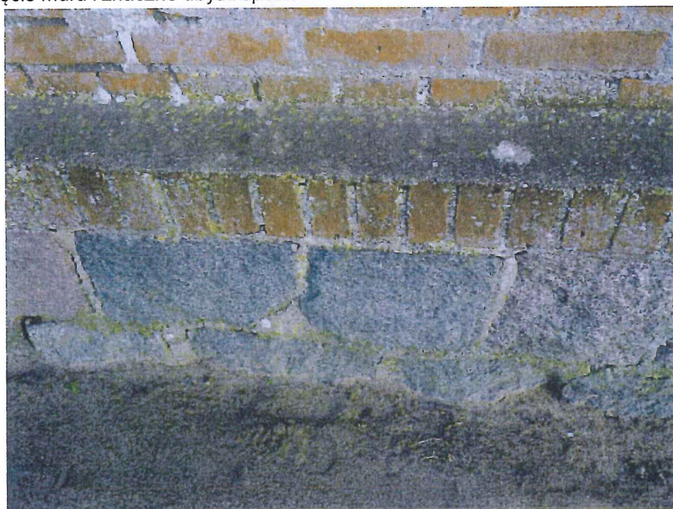
Fot.5. Fragment cokołu na kaplicy grobowej z wtórną, cementową wylewką.
