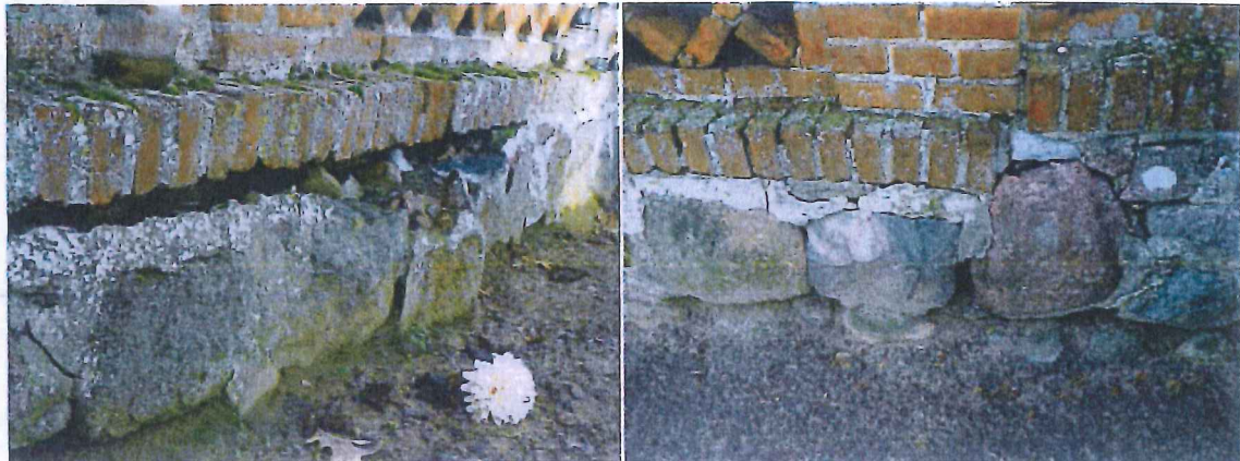
Fot.15. Stan zachowania partii cokołowej: ubytki spoin, korozja mikrobiologiczna, wtórne zaprawy cementowe.
