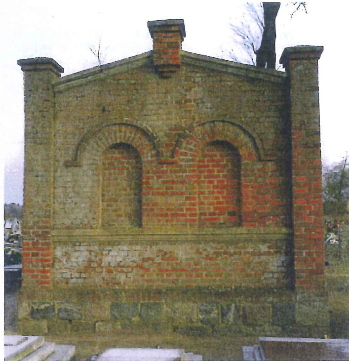
Fot.2. Kaplica grobowa od strony południowo-zachodniej. Stan zachowania.
