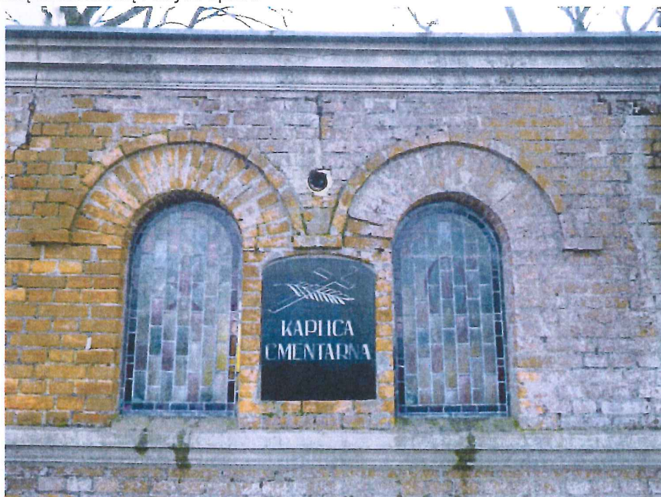
Fot.7. Fragment muru kaplicy od strony północno-zachodniej. Widoczne zniszczenia górnych partii muru: spękania, ubytki spoin, silne zasolenie i zawilgocenie.
