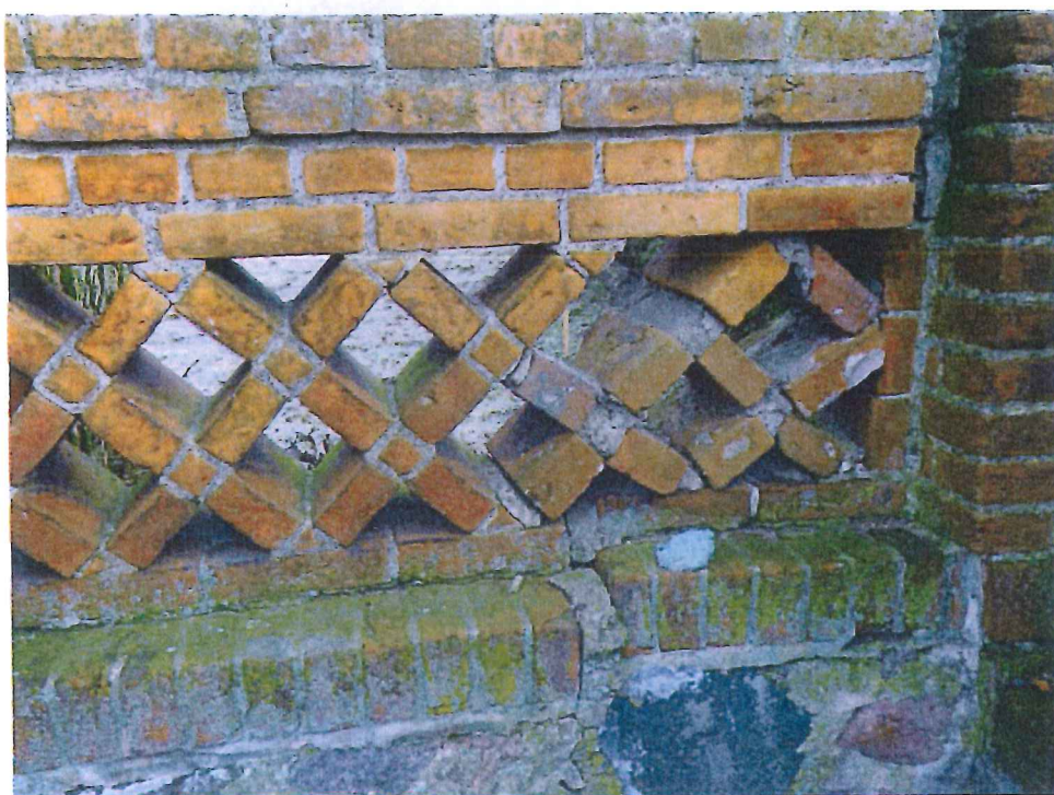
Fot.13. Przykład niestarannych przemuruowań bez zachowania wątku muru i z zastosowaniem zaprawy cementowej.
